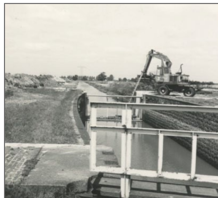
Figuur 6-2 Oude scheepvaartsluis in het Kanaal Buinen-Schoonoord waarin een beweegbare stuw wordt gebouwd (1974).
