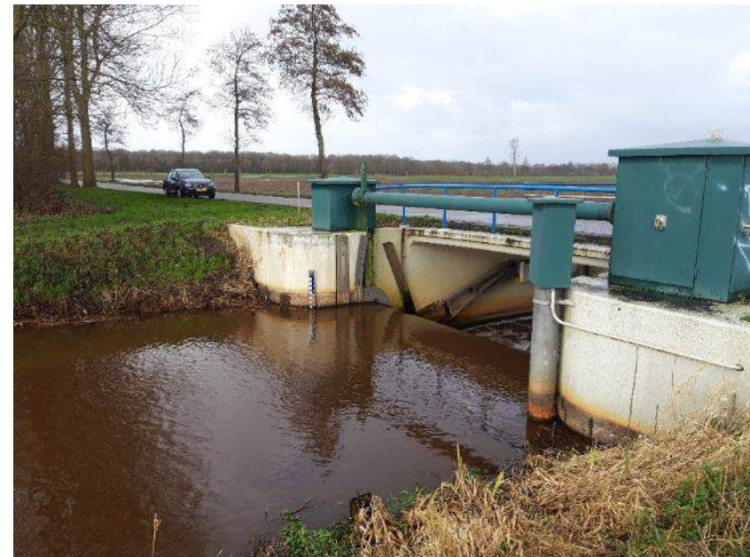
Figuur 1-2 Vismigratieknelpunt (stuw) op de grens tussen de Bronnegermaden en De Branden in het Voorste Diep.
